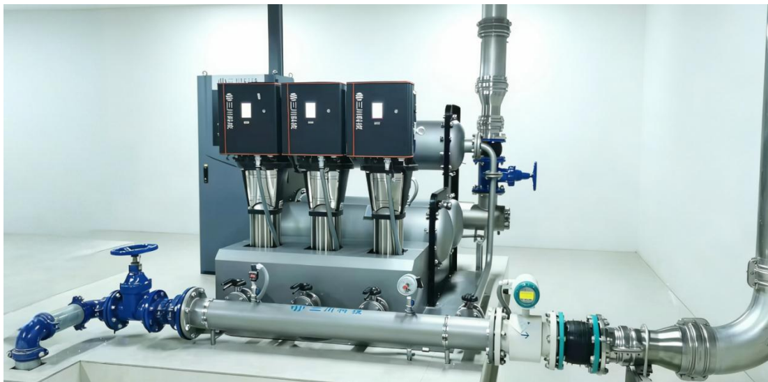
无负压供水设备
