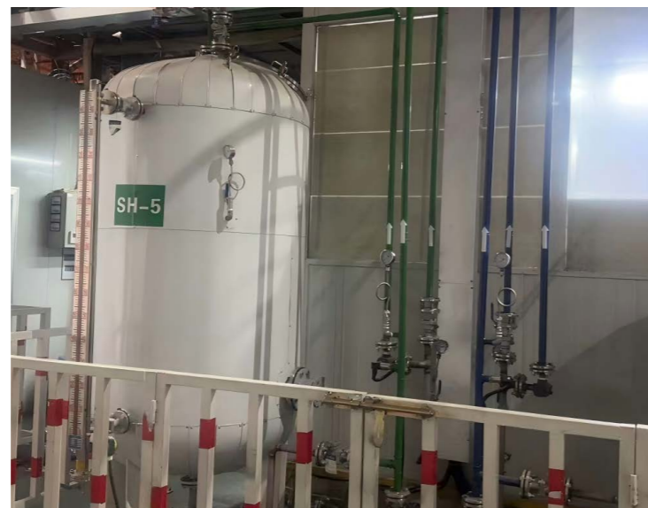
现场集中供油油罐
