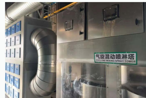
废气处理装置
