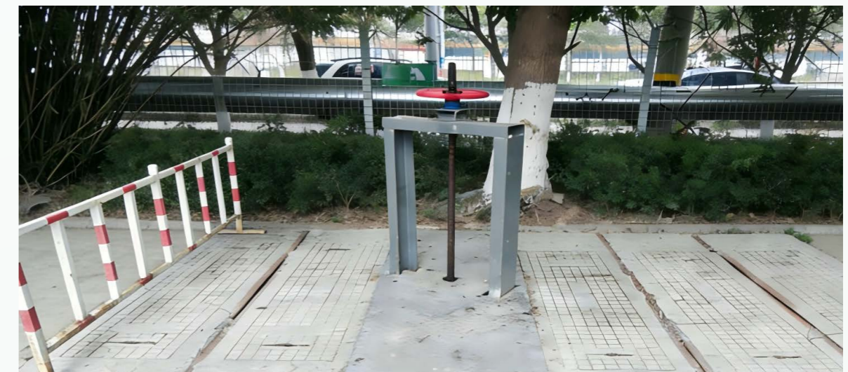
现场雨水收集池
