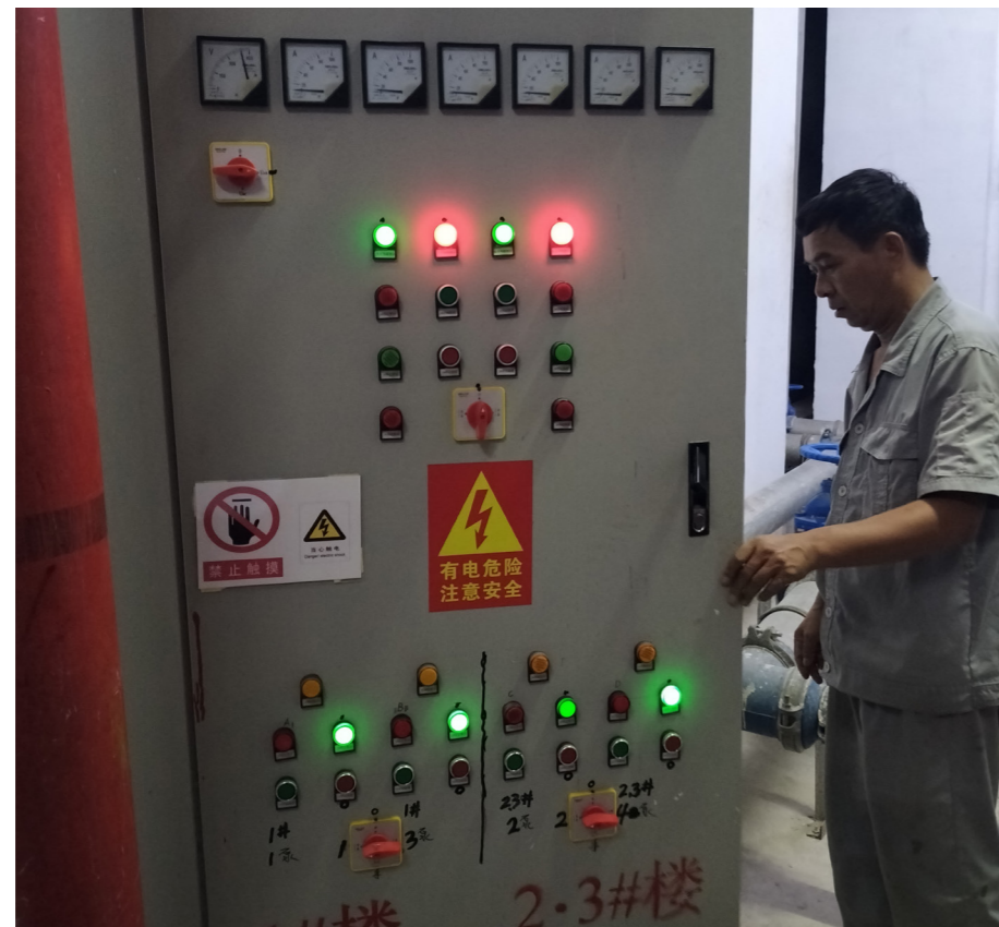
供水系统定期检查与保养
