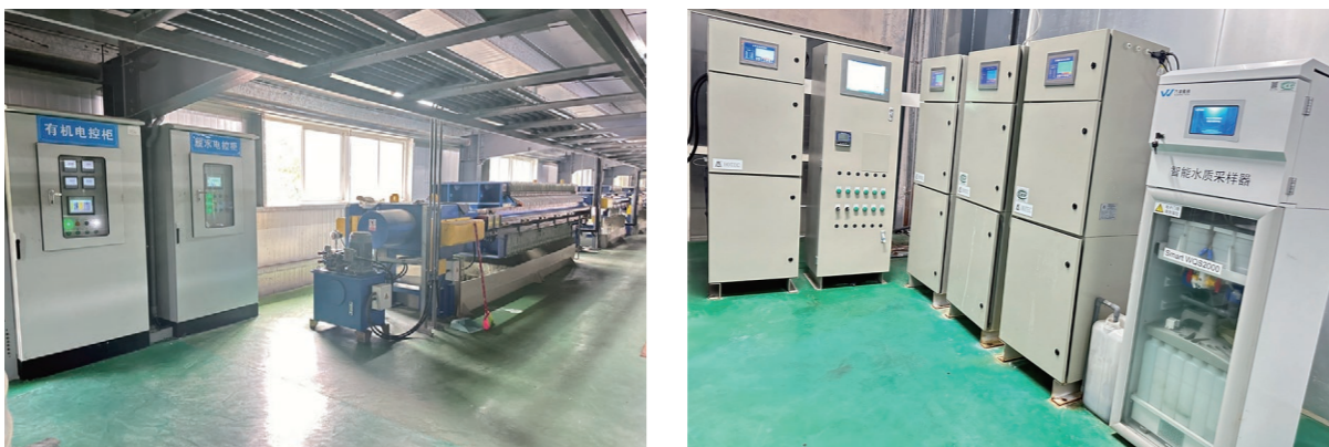
废水在线监测设施
