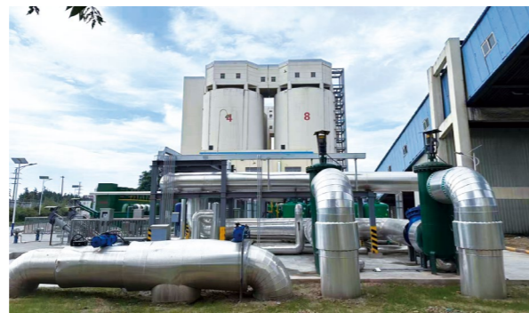
地下水压采技术项目
