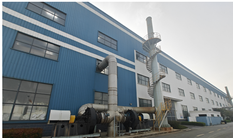
公司生产厂废气处理设备
