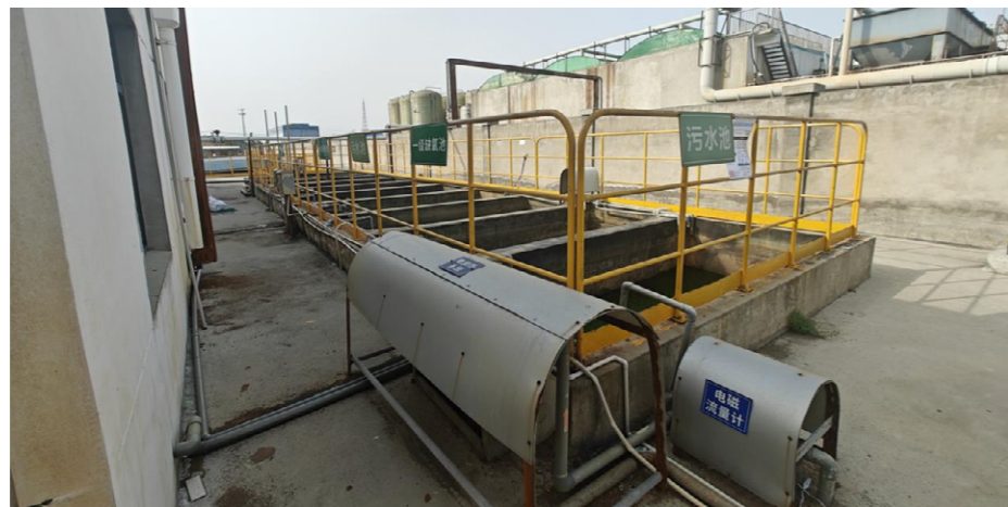
公司生产厂废水处理设施
