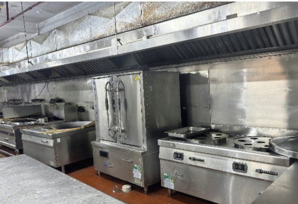
更新炉灶设备
